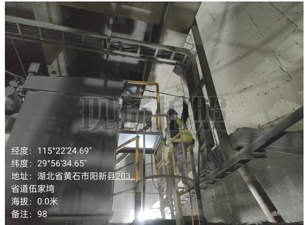
水泥库底 2 输送 DA098 有组织排放废气检测点位
