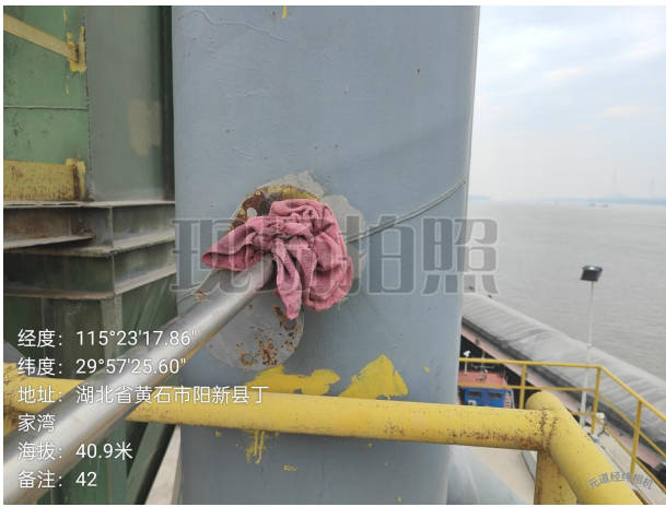
码头 2#泊位原煤进厂输送皮带 DA042 有组织排放废气检测点位
